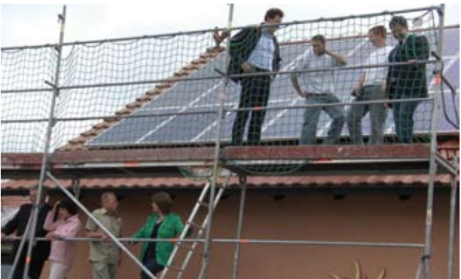
Photovoltaikanlage, im Rahmen des 100-Dächer-Plus-Programms errichtet
