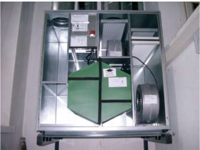
Lüftungsgerät im Innenbereich
